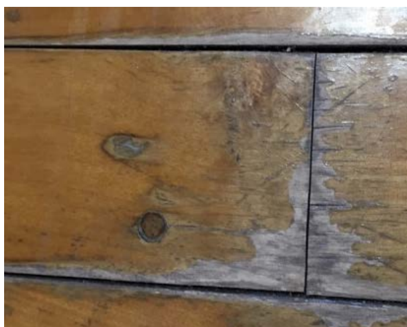
写真 10 塗装の剥がれ
