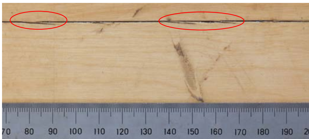
写真 11 事例 4 の現地調査で確認された表面材の裂け
